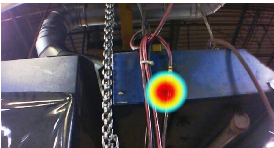
Image prise avec la caméra acoustique industrielle ii900 d'une fuite d'air dans un environnement industriel.
